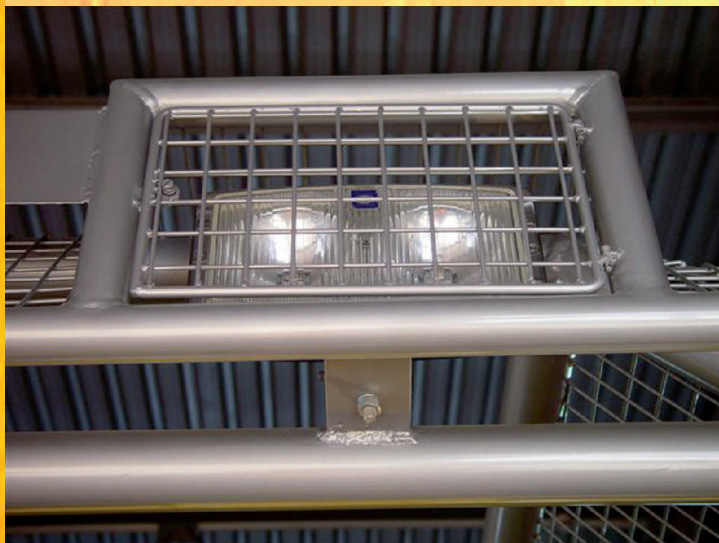
Najwyższe reflektory dachowe również zabezpieczono stalową siatką ochronną.
